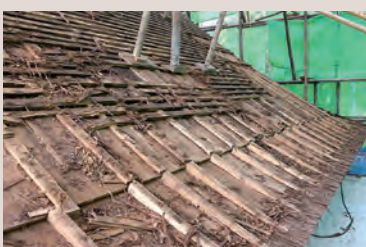
▲ご本殿の傷んだ屋根の様子
